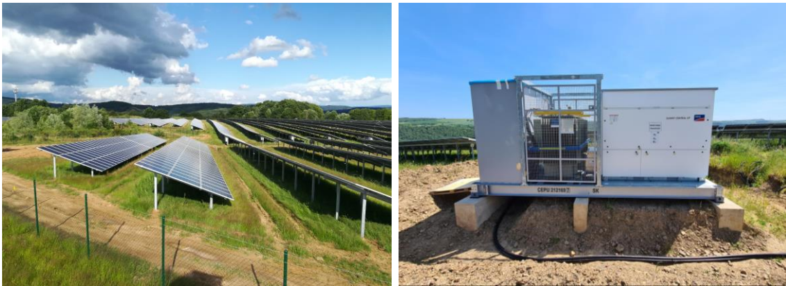
Abb. 1 Blick auf eine konventionelle südexponierte PV-FFA ein halbes Jahr nach dem Bau (2016) (links) und Kombistation (Trafo, Zentralwechselrichter und Schaltanlage) auf Streifenfundamenten (rechts)
